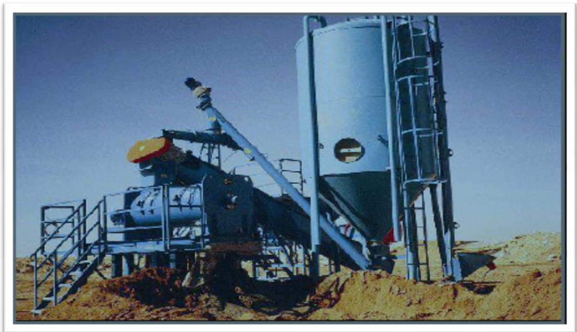
Figure IV.6 : Unité de Solidification
