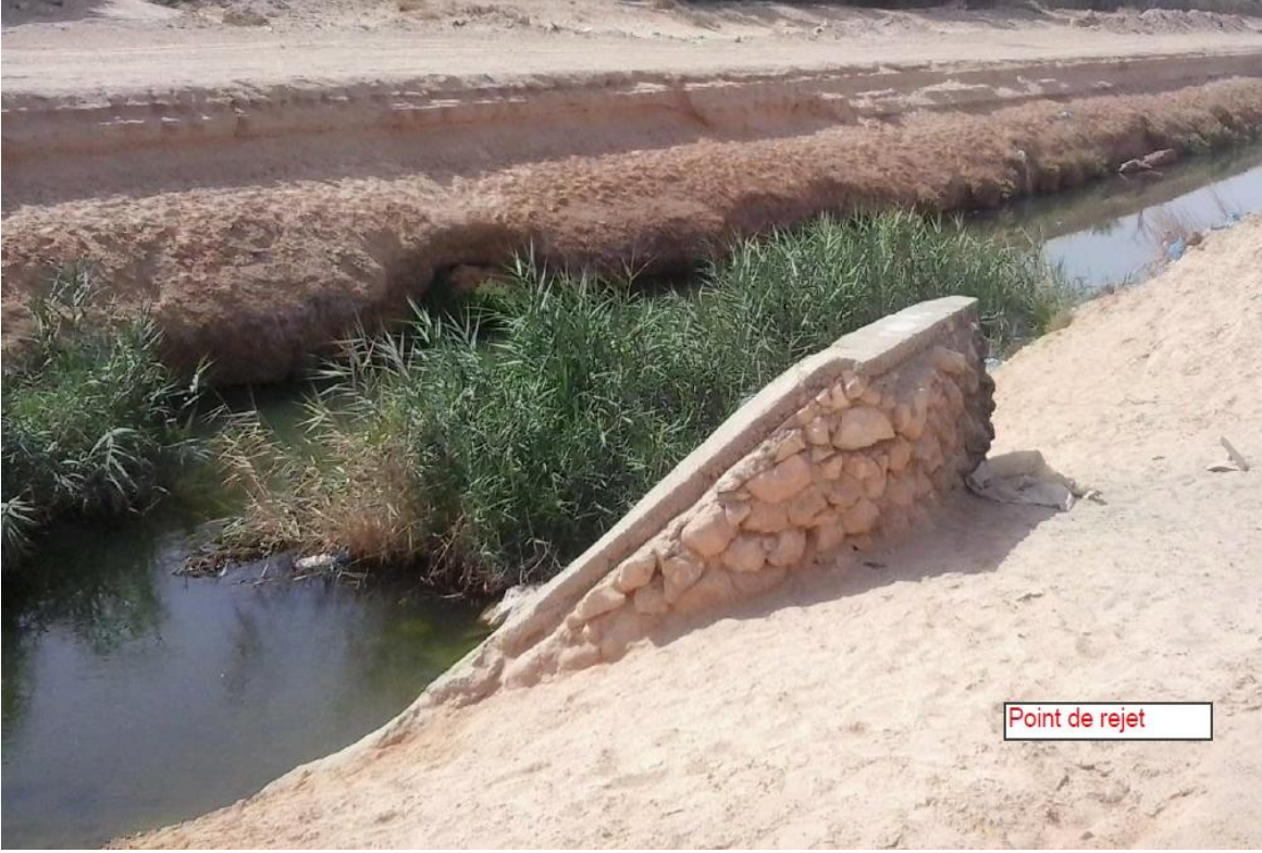
الشكل-7- صورة توضح قناة تفرغ مياه الرفض بواد ريغ [19]
