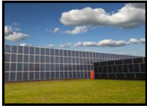
Figure I.18 : Panneaux photovoltaïques sur façade.
