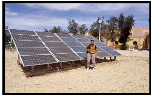
Figure I.16 : Panneaux photovoltaïques au sol sur structure
