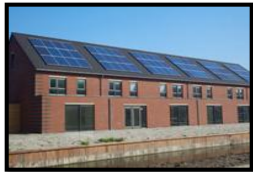
Figure I.14 : Panneaux photovoltaïques sur toit incliné de bâtiment résidentiel.
