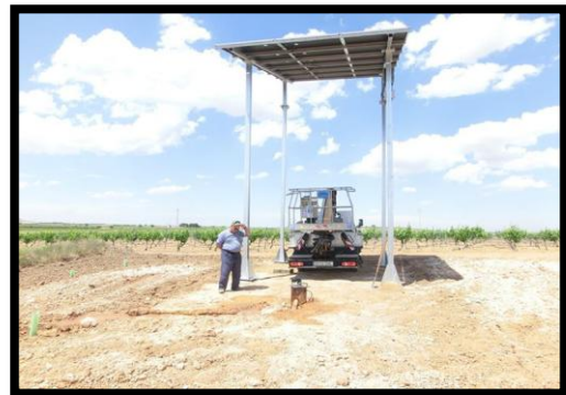
Figure I.19 : Panneaux photovoltaïques sur structure montée.
