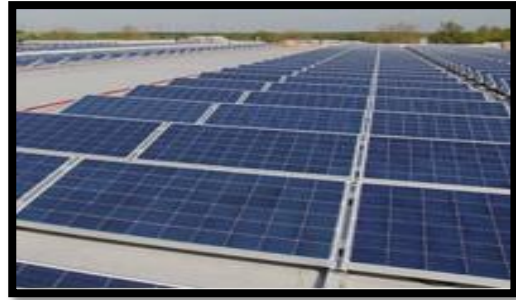
Figure I.15 : Panneaux photovoltaïques sur toit plat de bâtiment résidentiel.
