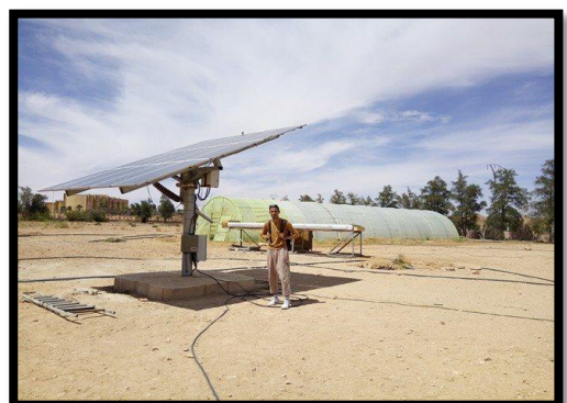
Figure I.17 : Panneaux photovoltaïques sur suiveur solaire.
