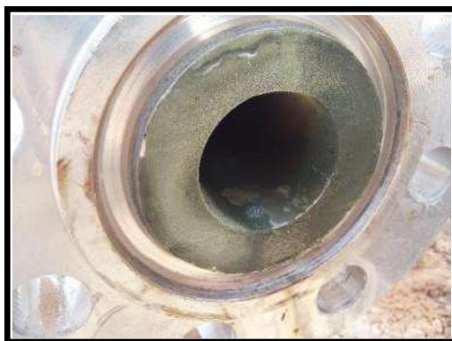
Figure III.17 : Dépôt de sels
