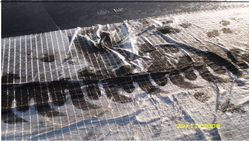
Figure IV.6 : Quelques problèmes de plissement du géo-grille
