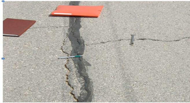
FIGURE II.14: Réparation des fissures + nouvelles fissures
