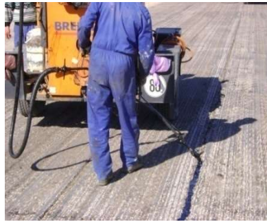
colmatage des fissures
