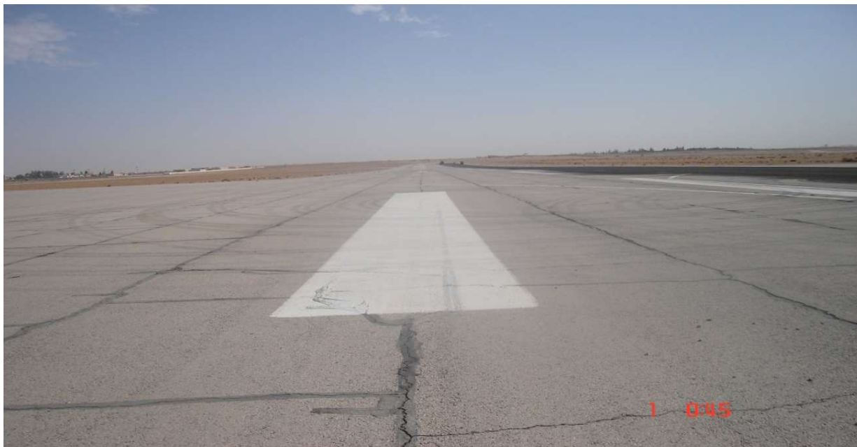
FIGURE II.4 : Fissures longitudinales et transversale piste 02/20 Aérodrome de Ouargla
