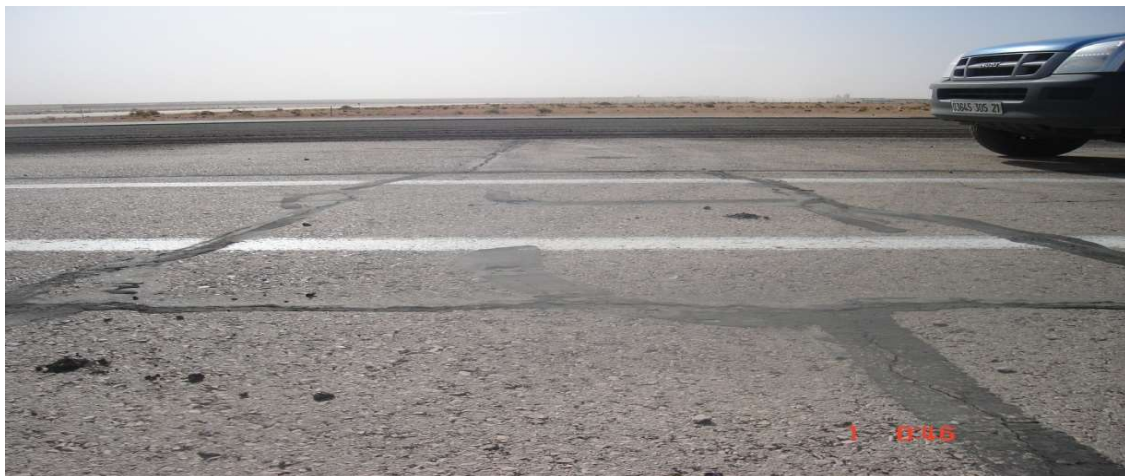
FIGURE II.5: Apparition des fissures à maille large colmaté en mastic Piste principale 02/20 Aéroport de Ouargla
