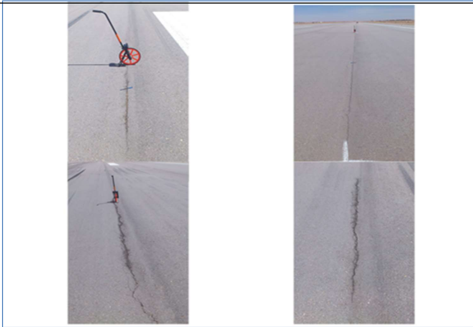
Figure IV.14 : Photos des ouvertures des joints longitudinaux
