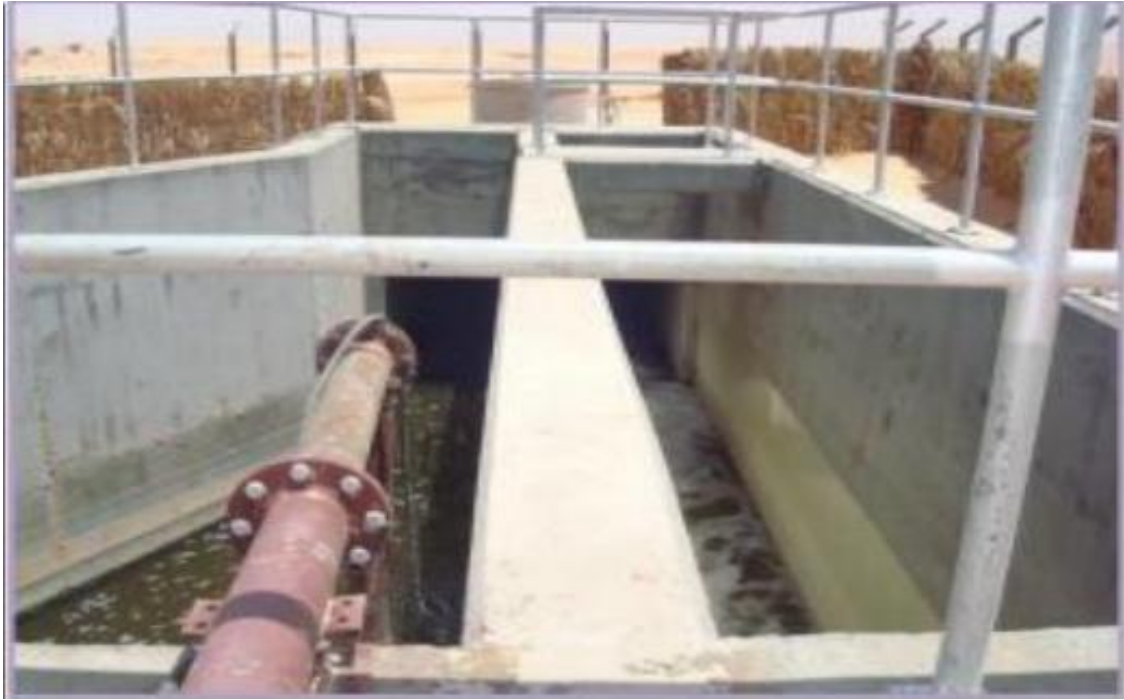
Figure (II-10): sortie des eaux épurées.
