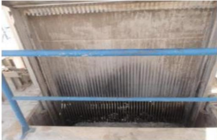
Figure (II-4): Dégrilleur.
