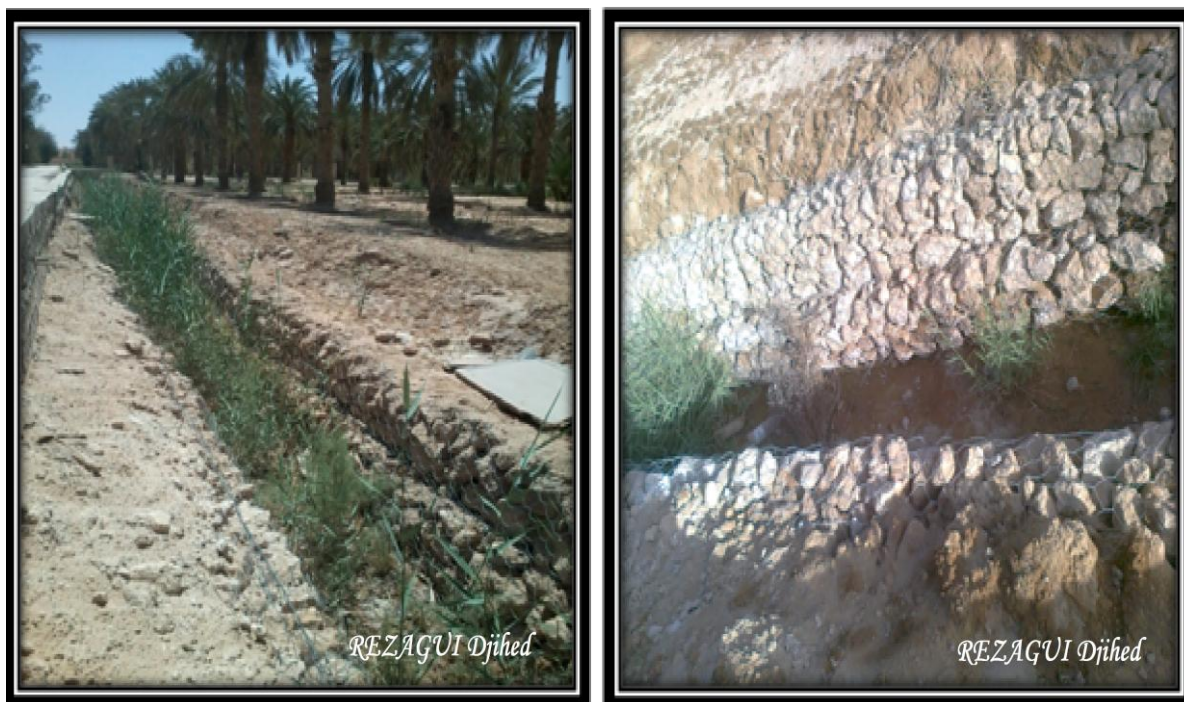
Photo III 4. L'état du réseau de drainage de l'exploitation
