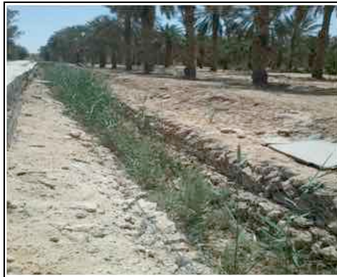
Photo 1. Etat du réseau de drainage à l'exploitation
