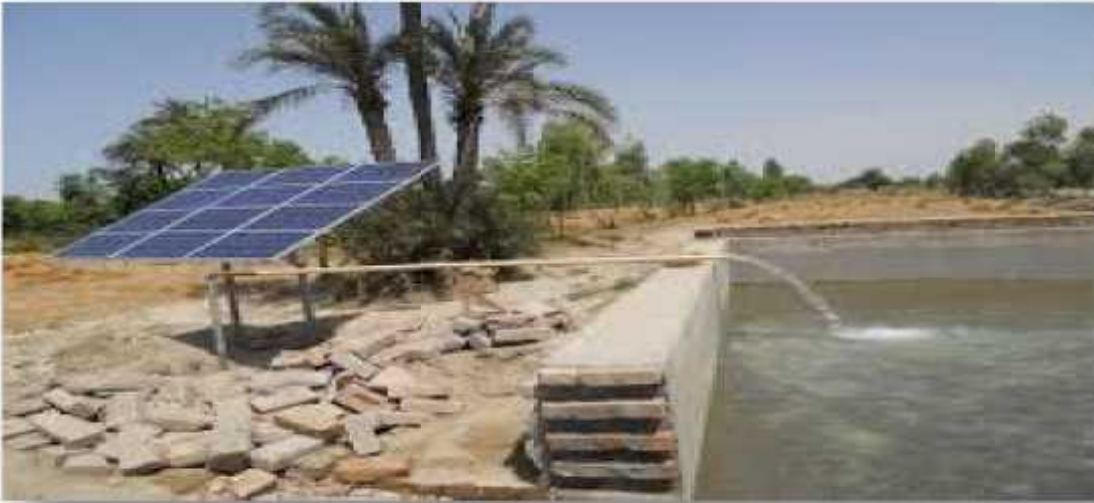
الشكل ( 3-11 ) مولد كهروضوئي مؤلف من 12 لوح شمسي (3)
