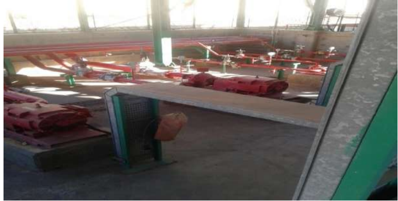
Fig. II. 12 : groupe de pompage
