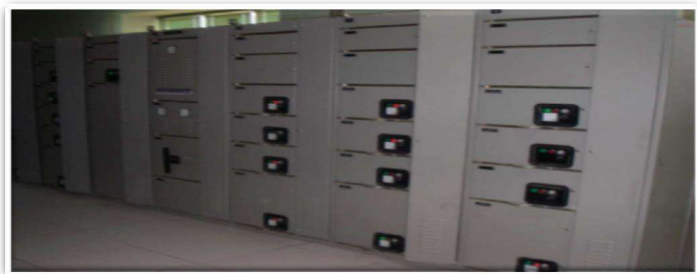
Fig. IV.2 : sous station électrique
