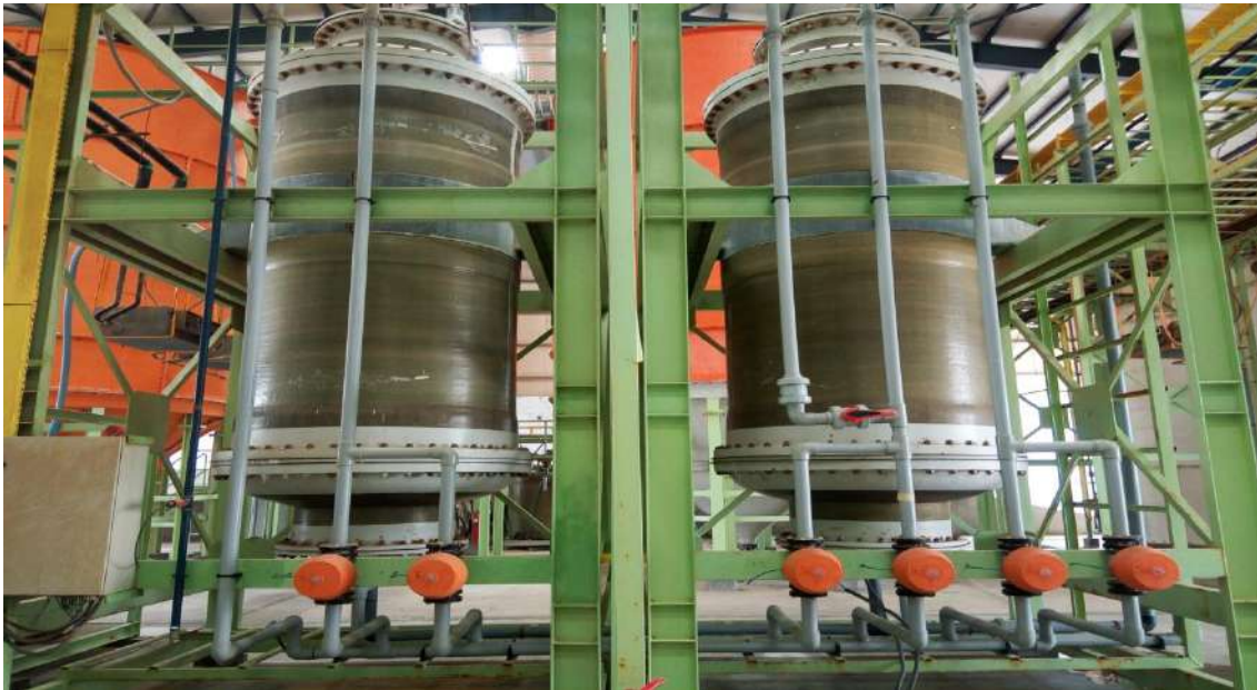
Figure n° (4) :filtration par filtre à sable
