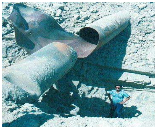
Figure I.3 : Eclatements avec rupture franche de la canalisation.
