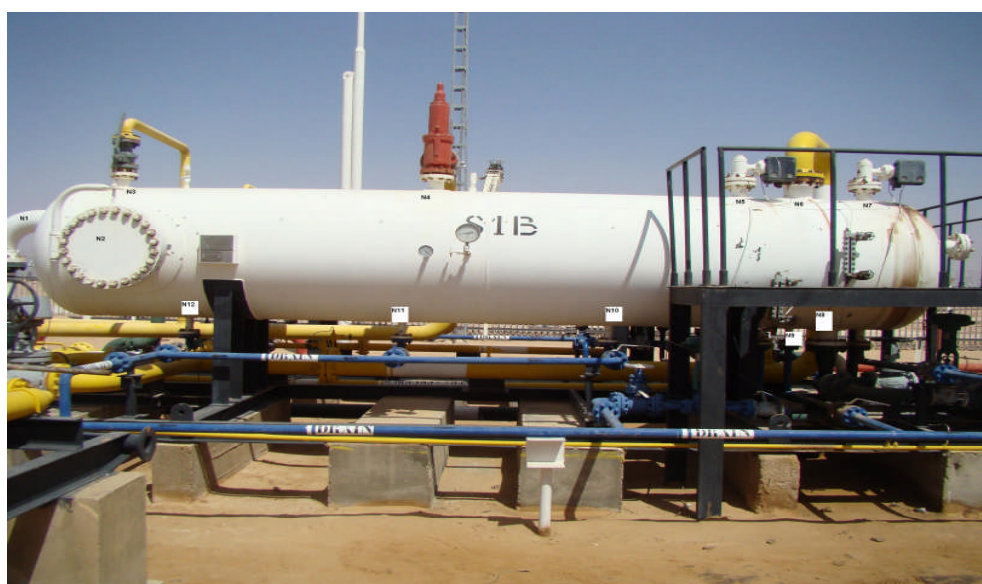
Figure (2) : Séparateur de traitement pétrole brut
