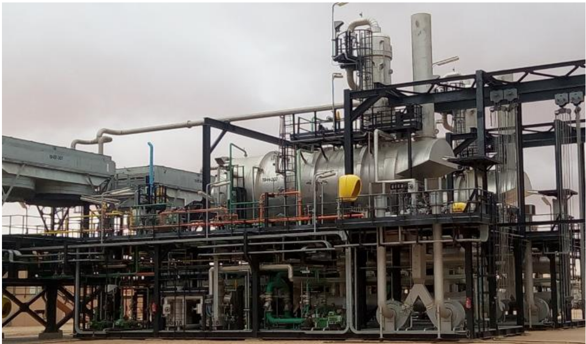
Figure I.8 : Unité de régénération du Glycol.
