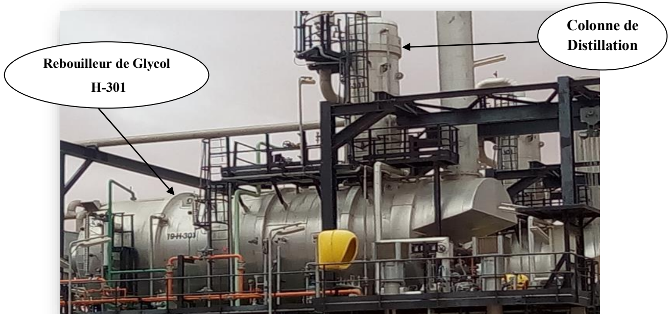
Figure I.14 : Rebouilleur de Glycol H-301.
