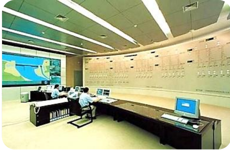
Figure II. 6 Salle de contrôle
