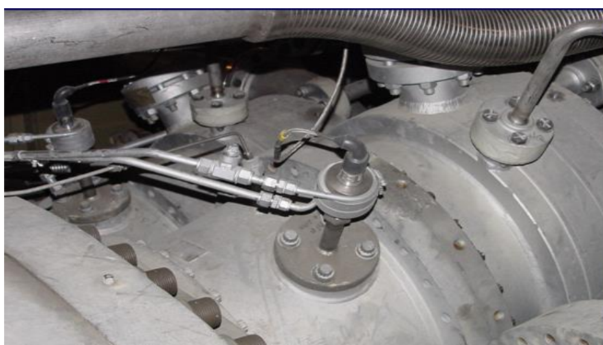
Figure 16 : Vue de Détecteurs de flamme
