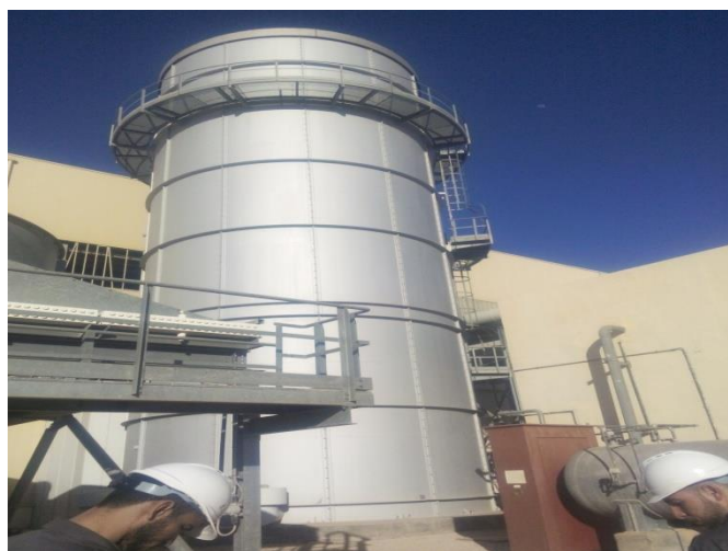
Figure 25 : Vue réel de la chambre d'échappement.
