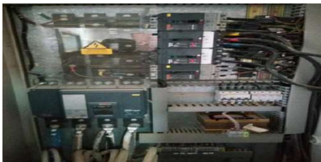
Figure I.13 : Armoire de commande.
