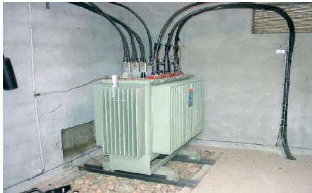
Figure I.20 : poste transformateur sous cabine. [2].
