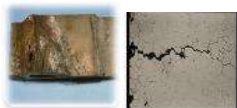
Figure(I.8): la corrosion sous contrainte
