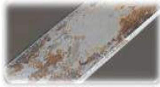
Figure(I.9): la corrosion par frottement
