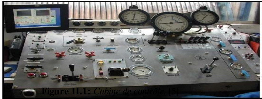
Figure II.1 : cabine de contrôle .[5]
