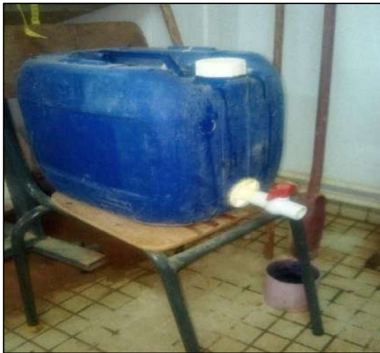
Figure N 23 .petite citerne pour remplissage des colonnes par les eaux usées épurés
