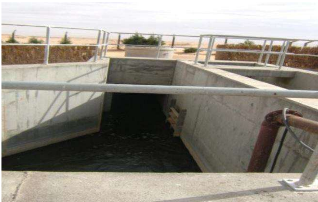
Figure N 20 .la conduite de sortie des eaux usées épurés vers le milieu naturel sebkha Sefioun par une conduite à ciel ouvert STEP SAID OTBA OUARGLA
