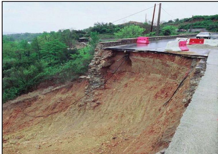
Figure I.1. Effondrement d'une partie du remblai constituant une route.
