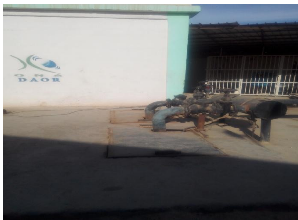
Photo.06 : représente les pompes de relevage de la STEP de Touggourt.
