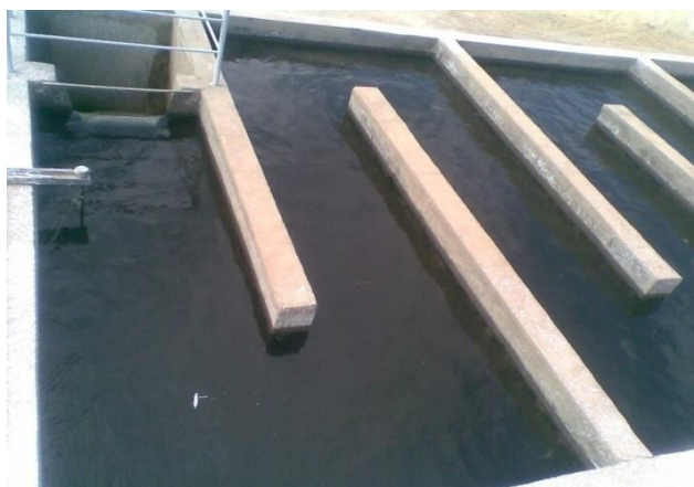
Photo.11 : représente un bassin de chloration.
