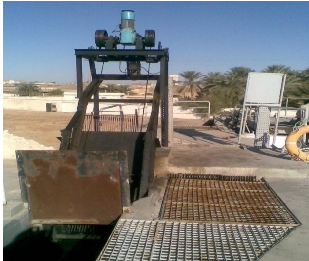
Photo.07 : Représente un Dégrilleur mécanique de type inclinée.
