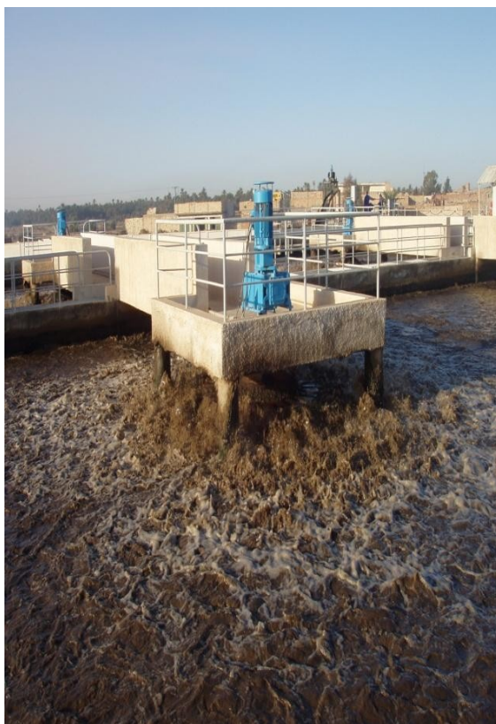
Photo.09 : représente un bassin d'aération.
