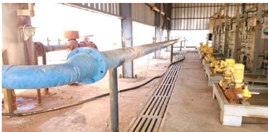
Figure (5.1) : STATION DE TRAITEMENT D'EAU PAR DES PRODUITS CHIMIQUE
