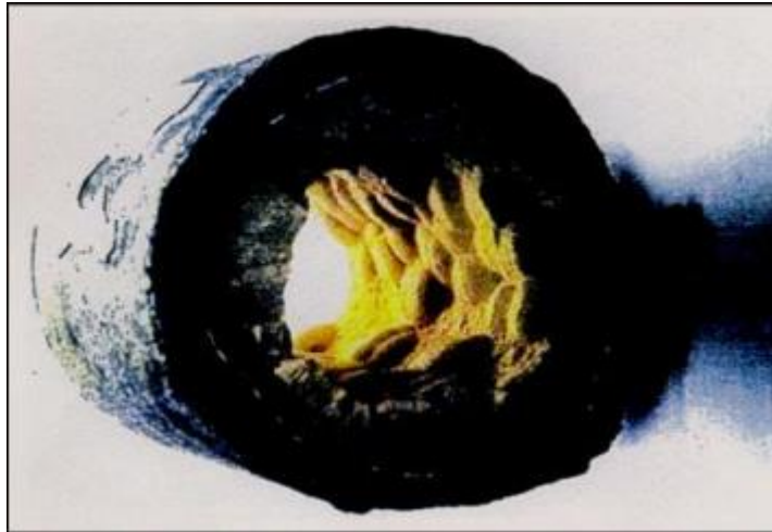
Figure (3.2) : Dépôt de sulfates
