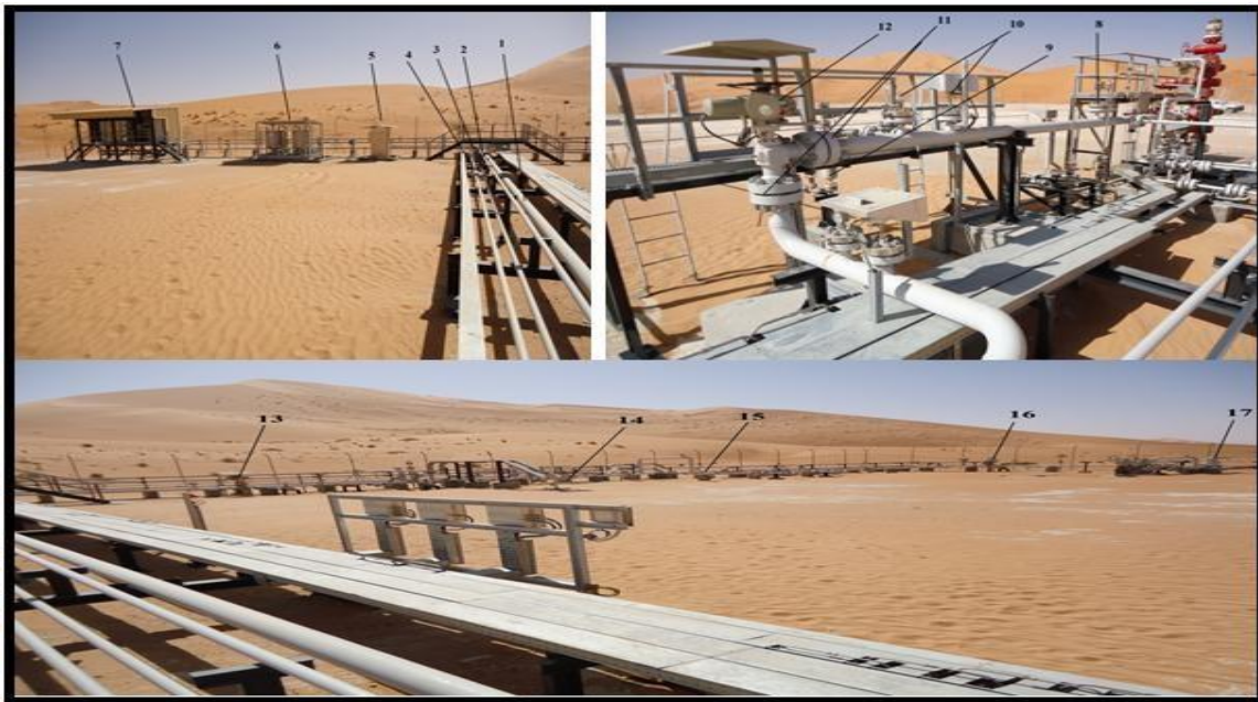
Figure I.8 : Installation de surface d'un puits producteur d'huile
