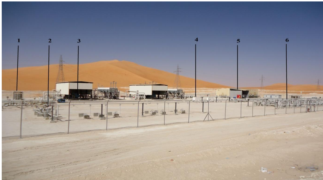
Figure I.9 : l'installation de surface du FGS
