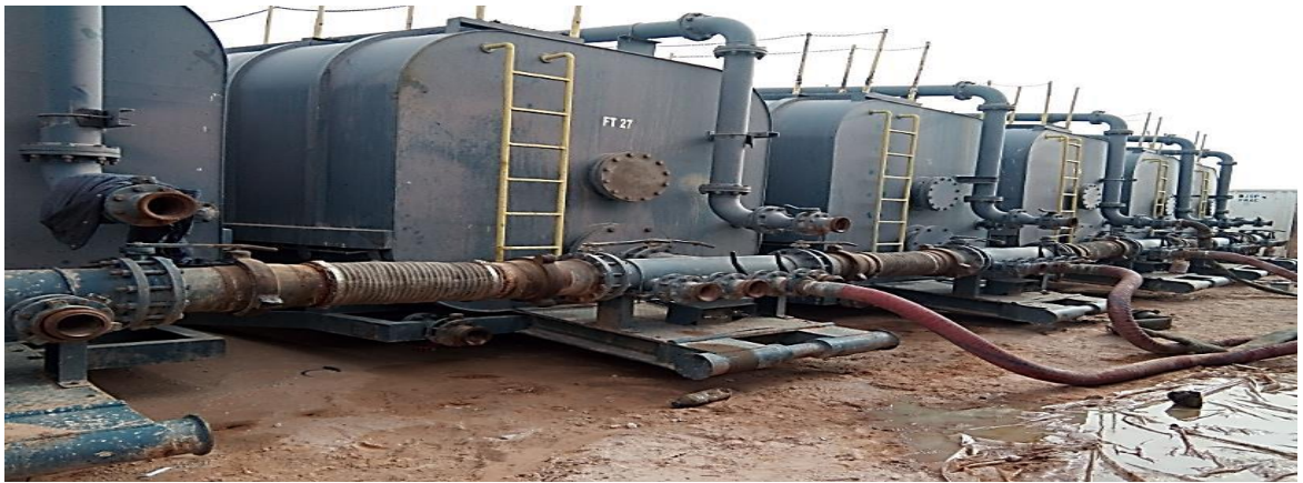
Figure 2.2: Réservoir d'eau (frac tank). [4]
