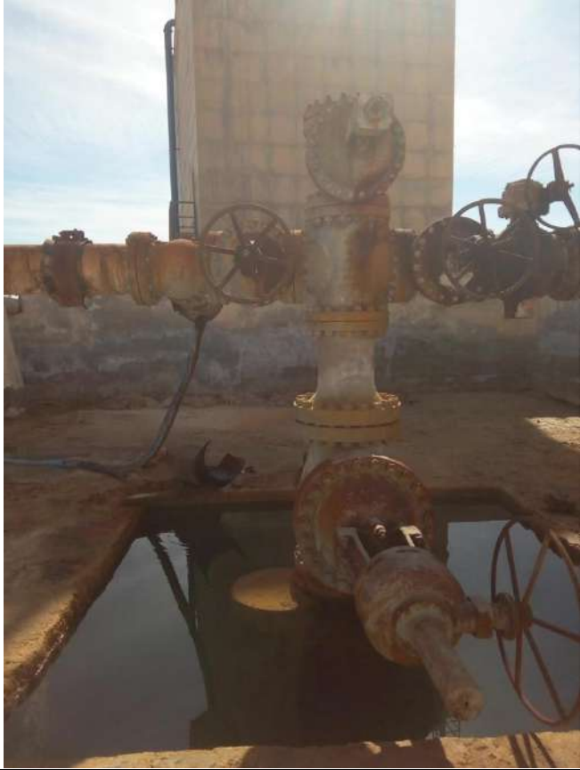
Tête de puit et refroidisseur du forage "16"
