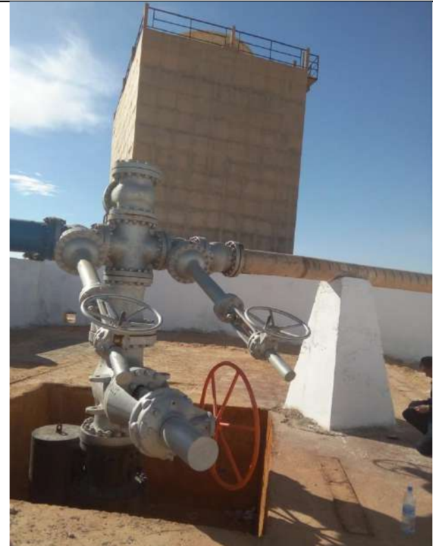
Tête de puit et refroidisseur du forage "13"
