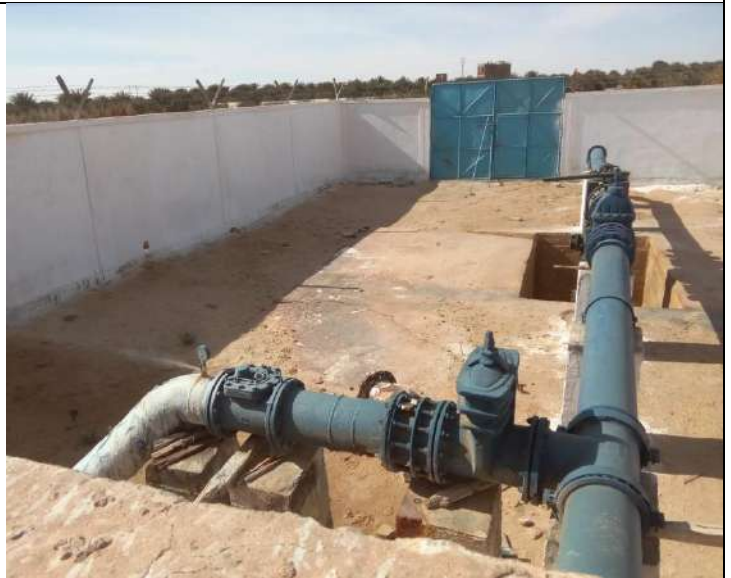
Tête de puit du forage n° 8 "Sidi Slimane"
