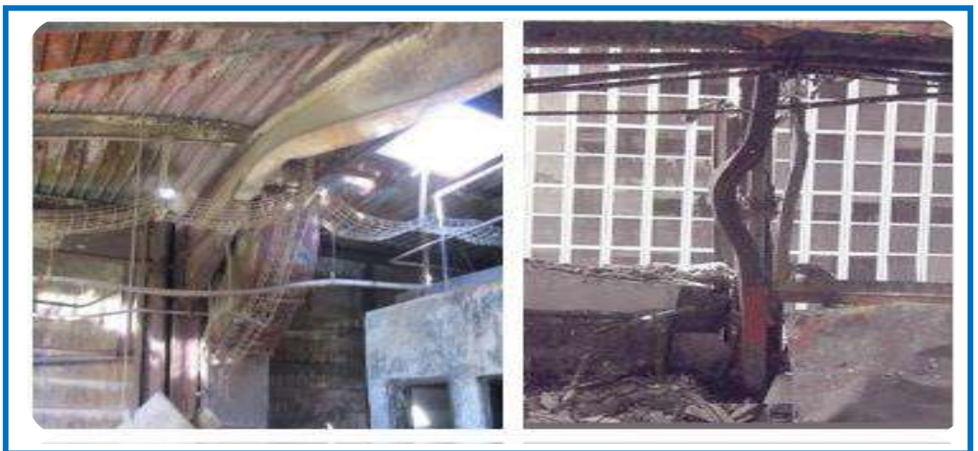
Figure I.10 exemples d'endommagement par incendie d'une poutre et d'un poteau.
