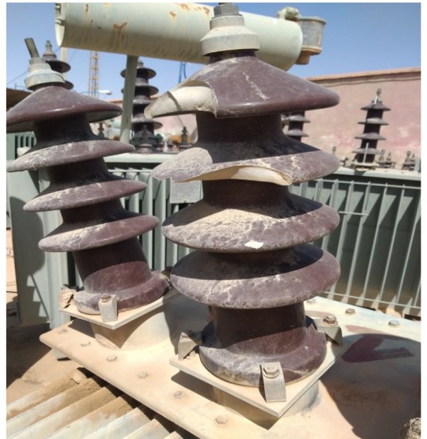
Figure (II.10) : Défaut de borne MT cassée
