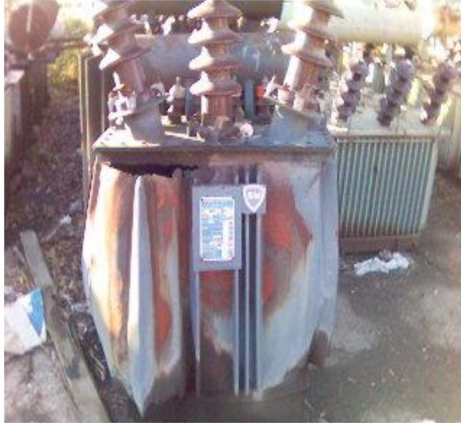
Figure (II.5) : Défaut à cause d'une foudre
