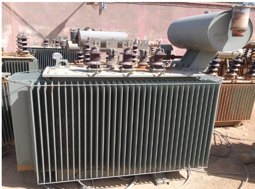
Figure(II.3) : transformateur de puissance
