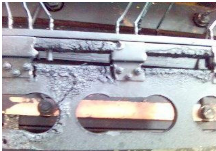
Figure (II.11) : Défaut de circuit magnétique « déformation »
