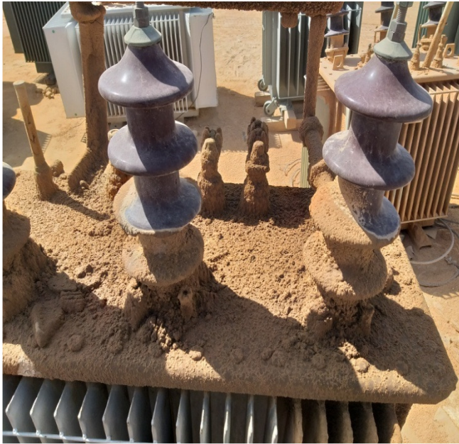
Figure (II.9) : Défaut de pollution
