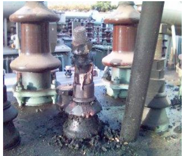
Figure (II.8) : Défaut de pollution
