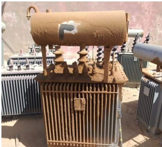
Figure(II.7) : Défaut serrage sur borne BT
