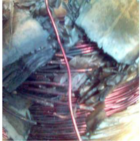
Figure(II.6) : Défaut de court circuit
