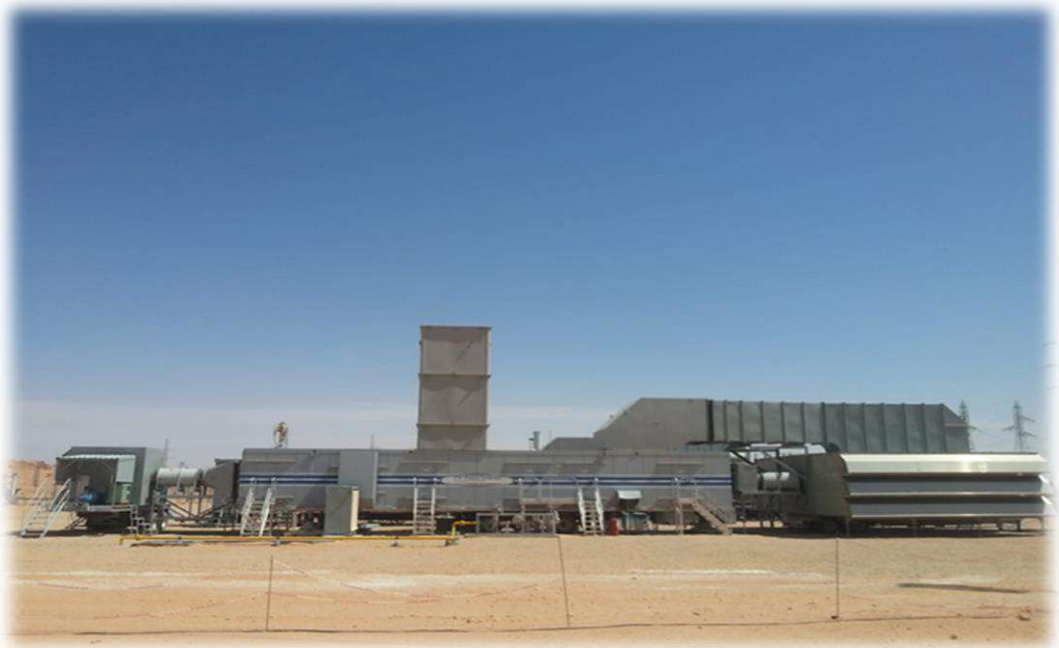
( Figure II.1 ) : Turbine à gaz FT8 dans centrale mobile d'OUARGLA
