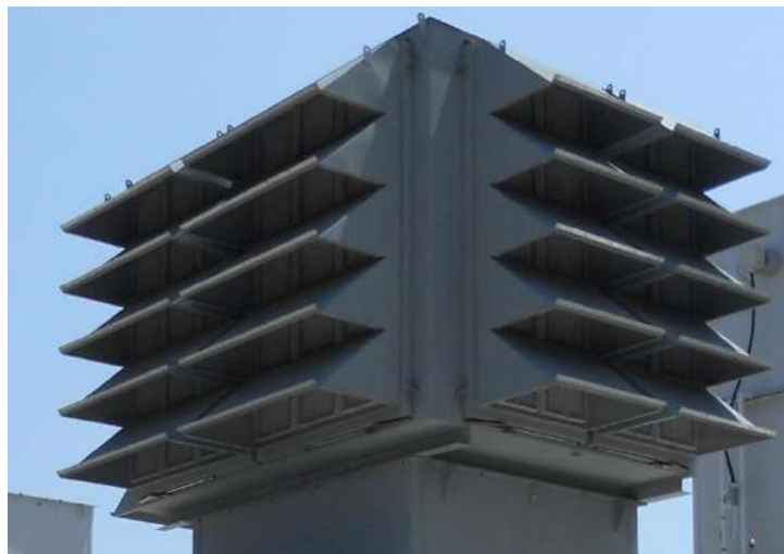
(Figure II.7): Corps de filtre d'admission à trois faces MP25 classique - les pré-filtres sont à peine visibles derrière la protection anti-pluie
