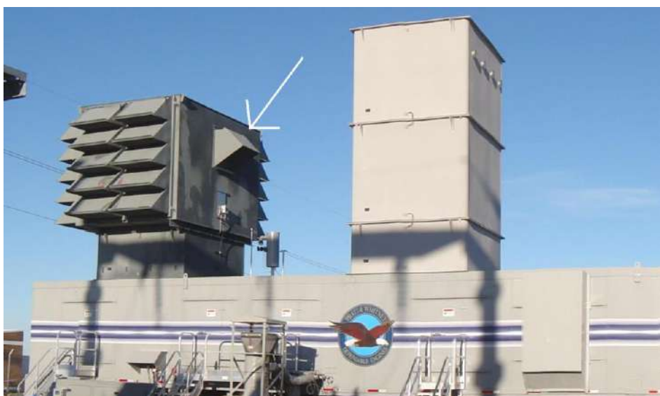
(Figure II.8) : Corps de filtre d'admission avec une flèche indiquant le registre actionné par la gravité
