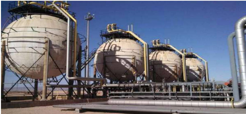
FigureI.4 : Sphères de stockage du GPL (15-T-401- A/B/C) .
