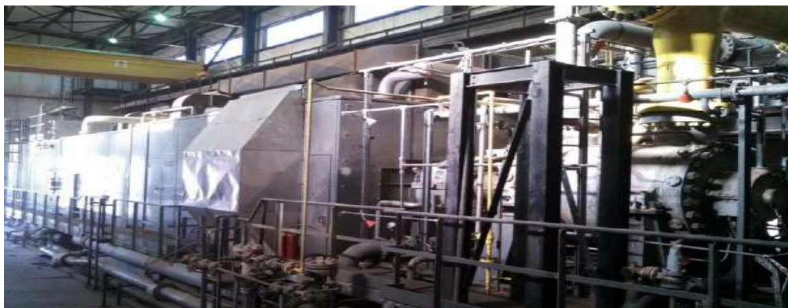
Figure I.2: Compresseur (10-K101 A/B/C/D).
