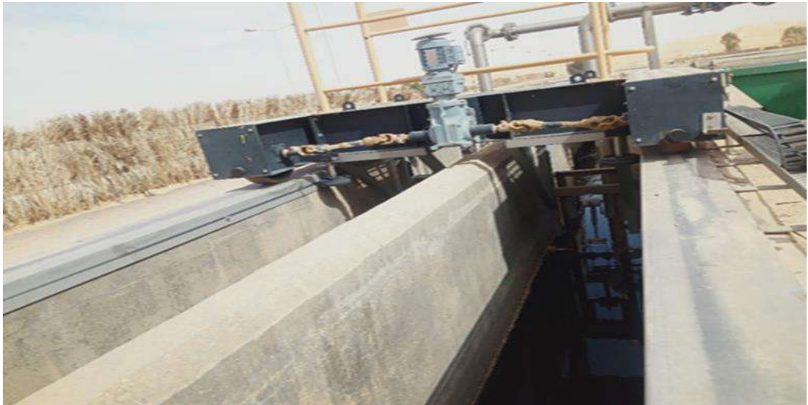
Figure II.9 : Système de dégrillage
