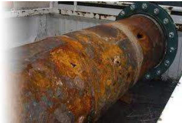
Figure 1.11 : Conduite d'acier corrodée
