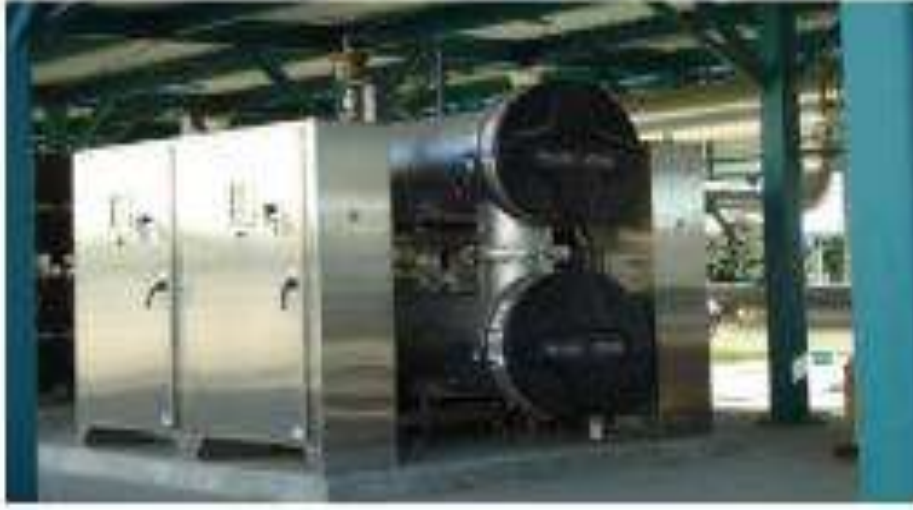
الشكل (19) : وحدة المعالجة بالأشعة فوق البنفسجية بأحد محطات المعالجة.
