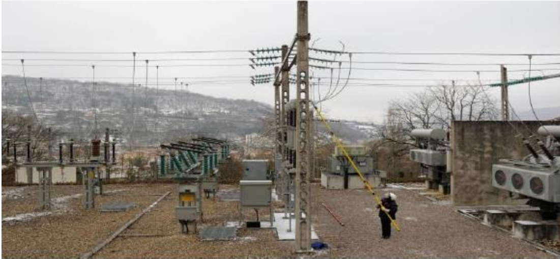
Figure 1.12 : accident d'origine électrique
