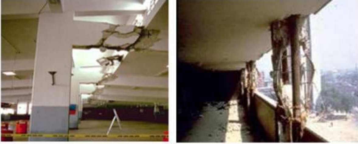
الصورة رقم(4) أضرار وانحيار الأعمدة القصيرة تحت تأثير القوي الزلزالية
