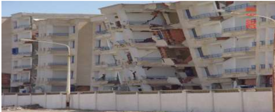
الصورة رقم(5) تصادم مبنيين لعدم استخدام الفواصل الزلزالية
