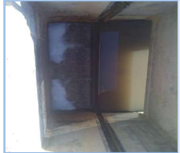
Photo 08: la sortie des eaux épurées
