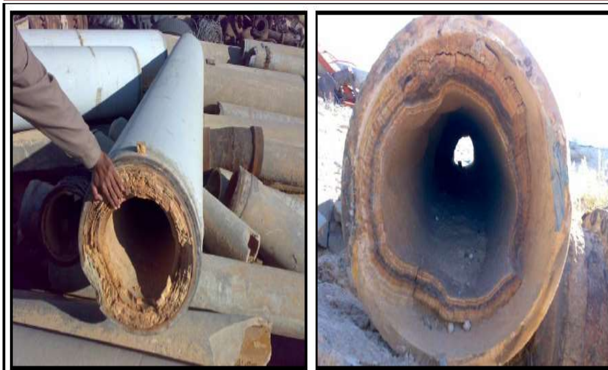
Figure.III 9: Phénomène d'entartrage des conduites (Mahboub Y et Abid O ; 2020)
