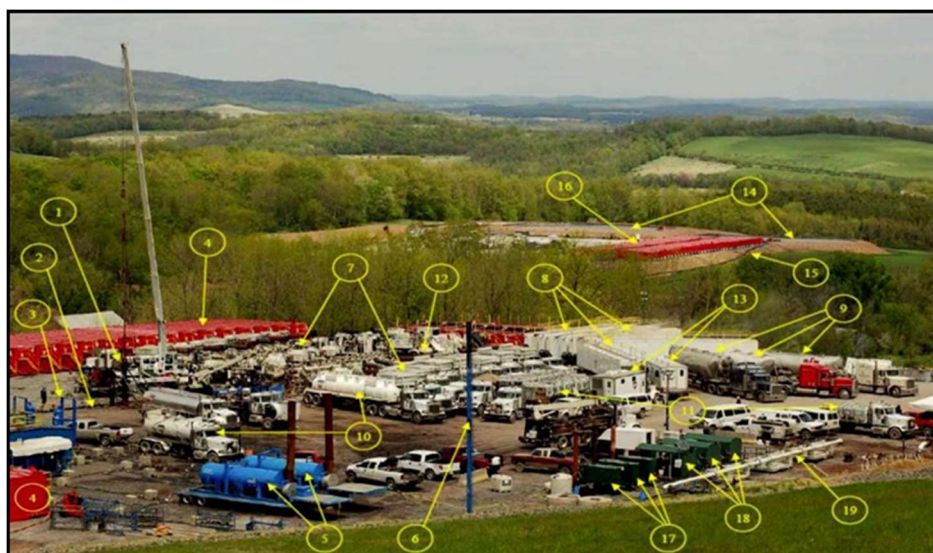
Figure I.13 : Equipements de Fracturation Hydraulique
