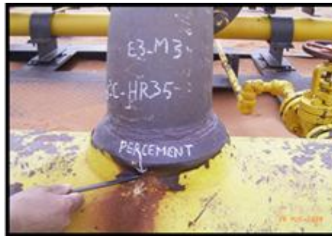
Figure II.6 : Le contrôle visuel des conduites corrodées
