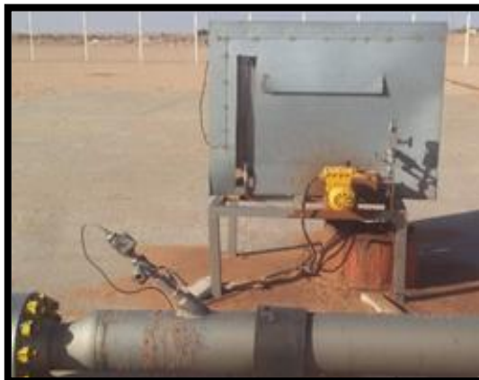
Figure III.3 : Pompe doseuse responsable à injecter l'inhibiteur de corrosion
