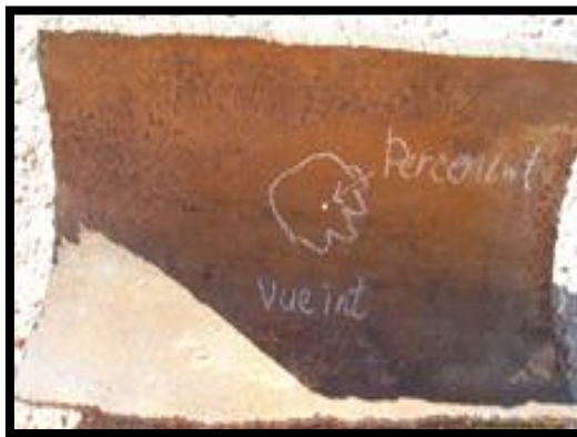
Figure II.5.1 : Percement d'une conduite enterrée (vue interne)
