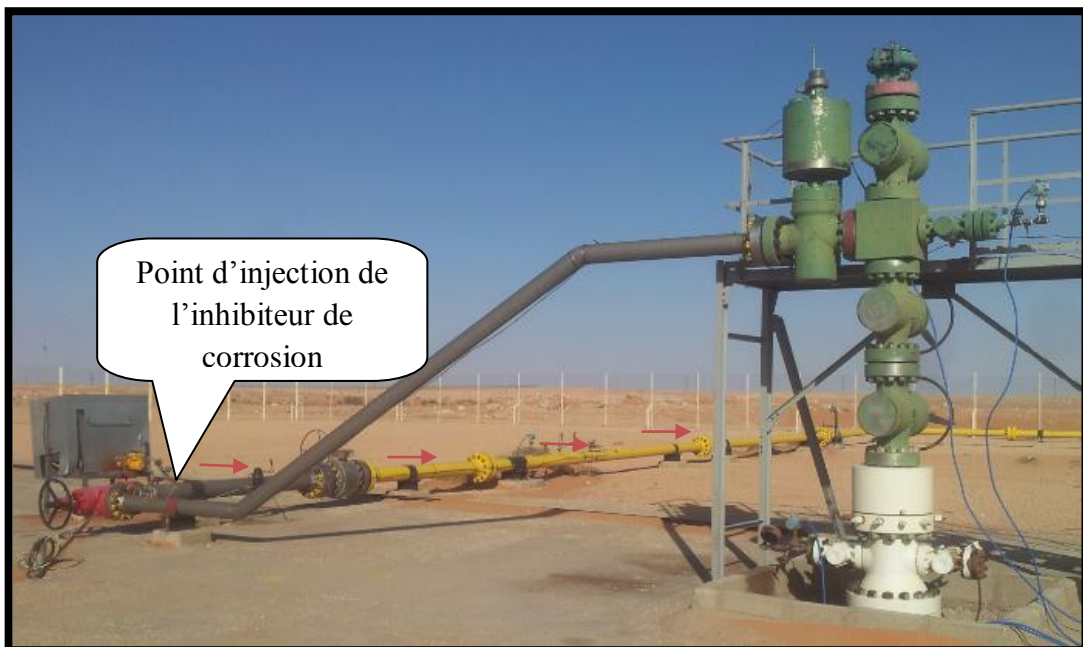
Figure III.2 : Point d'injection de l'inhibiteur de corrosion au niveau du puits
