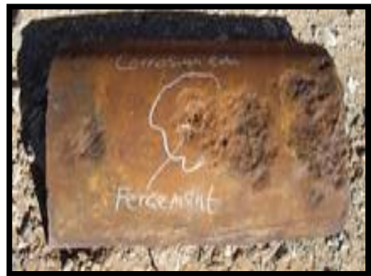
Figure II.5.2 : Percement d'une conduite enterrée (vue externe)
