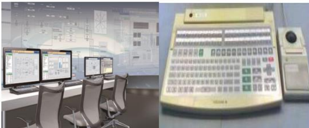
Vue de la salle de contrôle (stations HIS)
