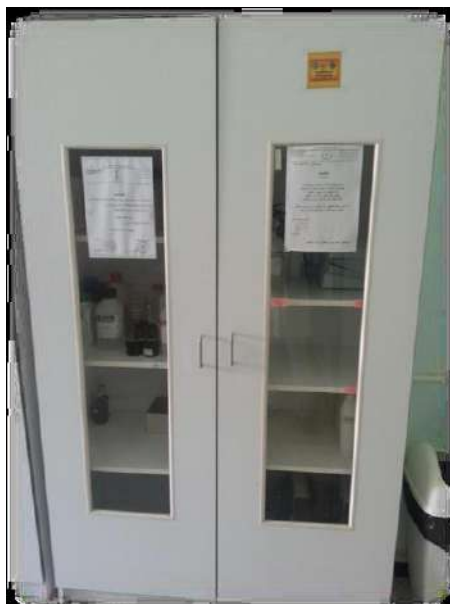
Figure 5 : Stockage des produits chimiques aux armoires
