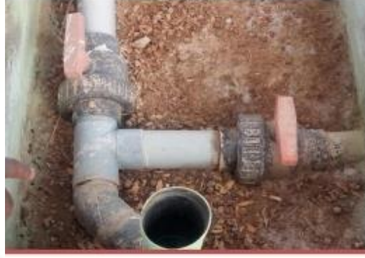
الشكل (09): علبه التحكم وأخذ عينات المياه الداخلة
