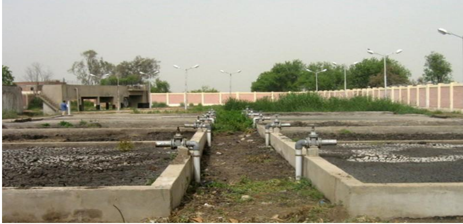
الشكل (07): أحواض التجفيف الطبيعي للحماة
