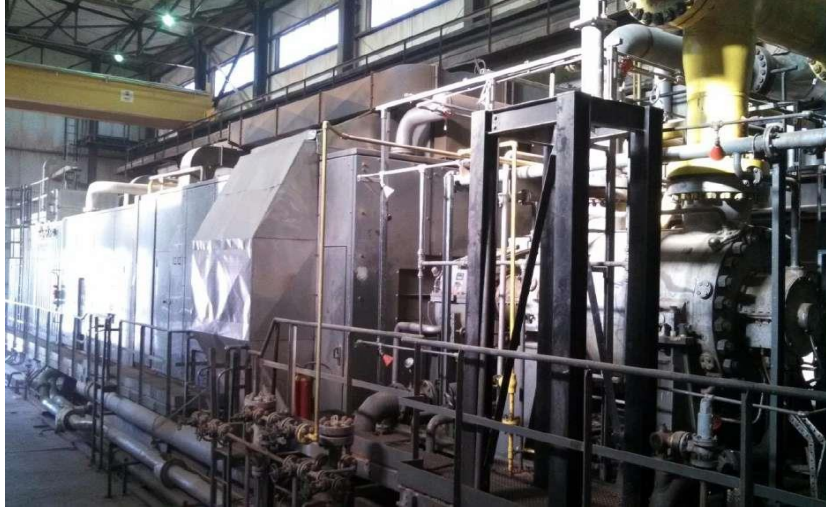
Figure III.01 : Compresseur (10-K101 A/B/C/D)
