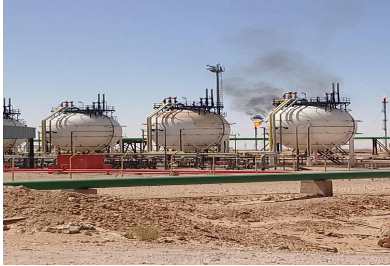
Figure III.04: Sphères de stockage du GPL (15-T-401- A/B/C).
