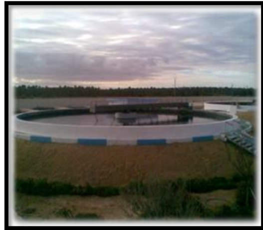
الشكل (16): صورة توضح محطة تصفية المياه تقرت
