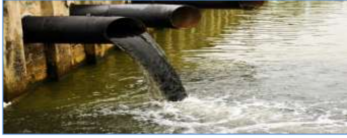
الشكل (II - 8): تلوث المياه بمياه الصرف الصحي
