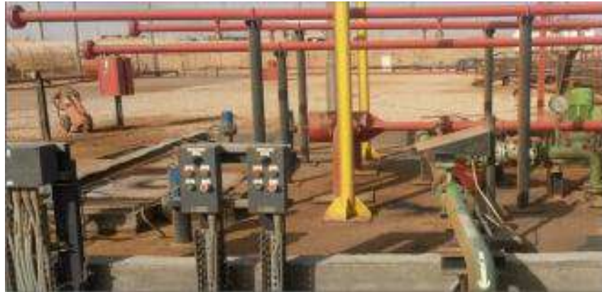
Figure.5: Puisard d'eau huileuse.
