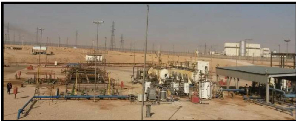
Figure.2: Unité de Traitement des eaux huileuse API.
