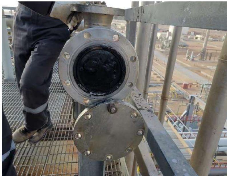
Figure III-7 : Bouchage de tuyau de gaz [1]
