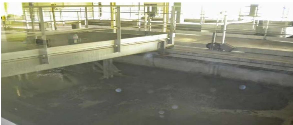
Figure I-4: prétraitement de déshuilage
