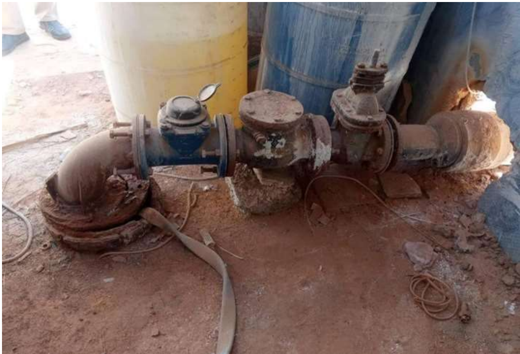
Les Figure N°14: Le puit de forage piscine de Ouargla
