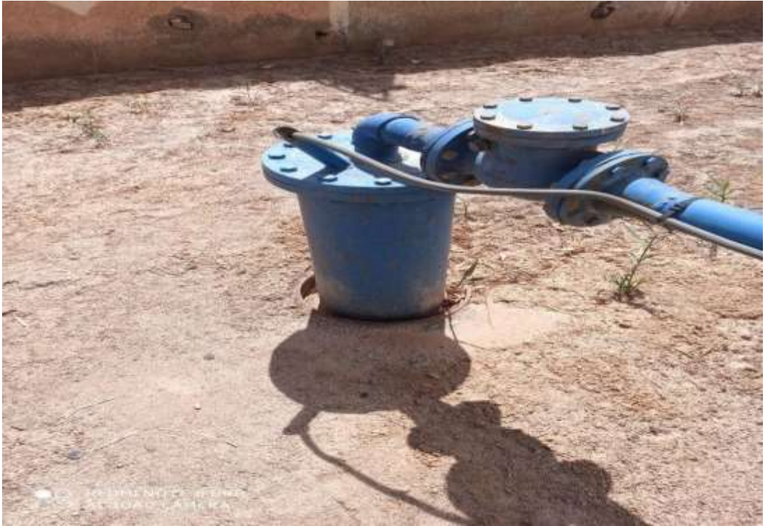
Les Figure N°15: Le puit de forage piscine de touggourt
